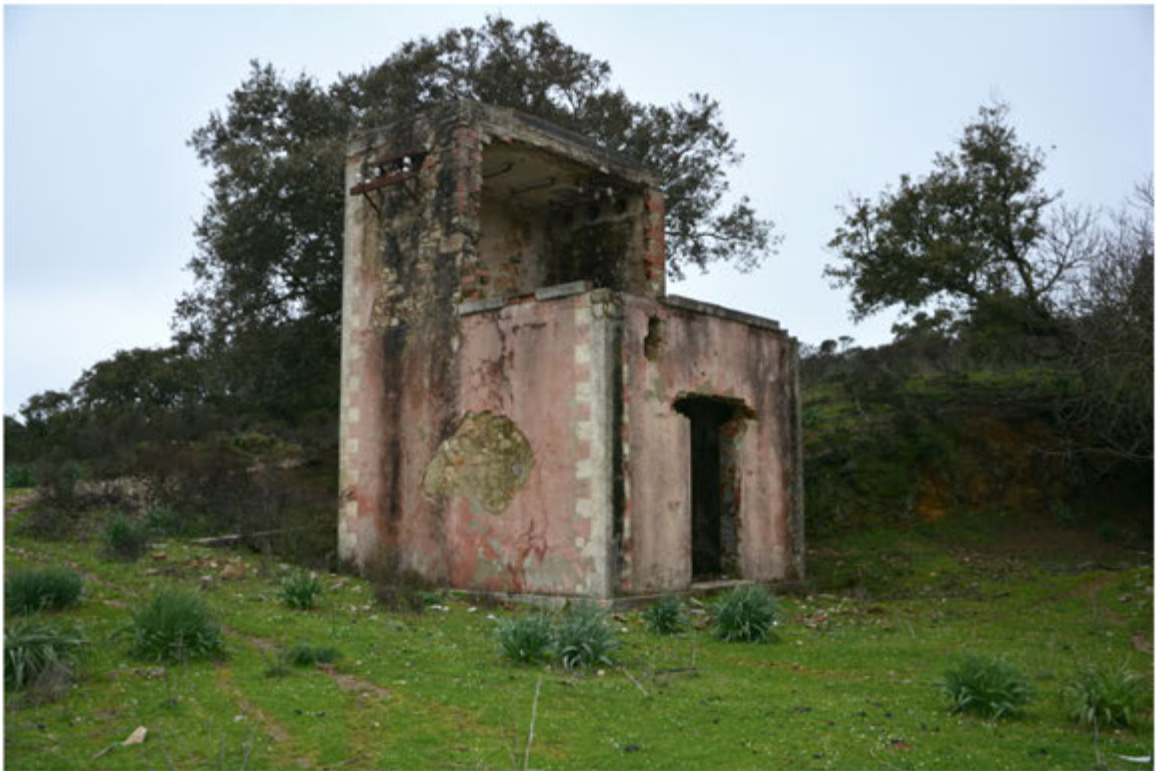
Foto 21: Foglio 512 cabina enel in terreno mapp.58
